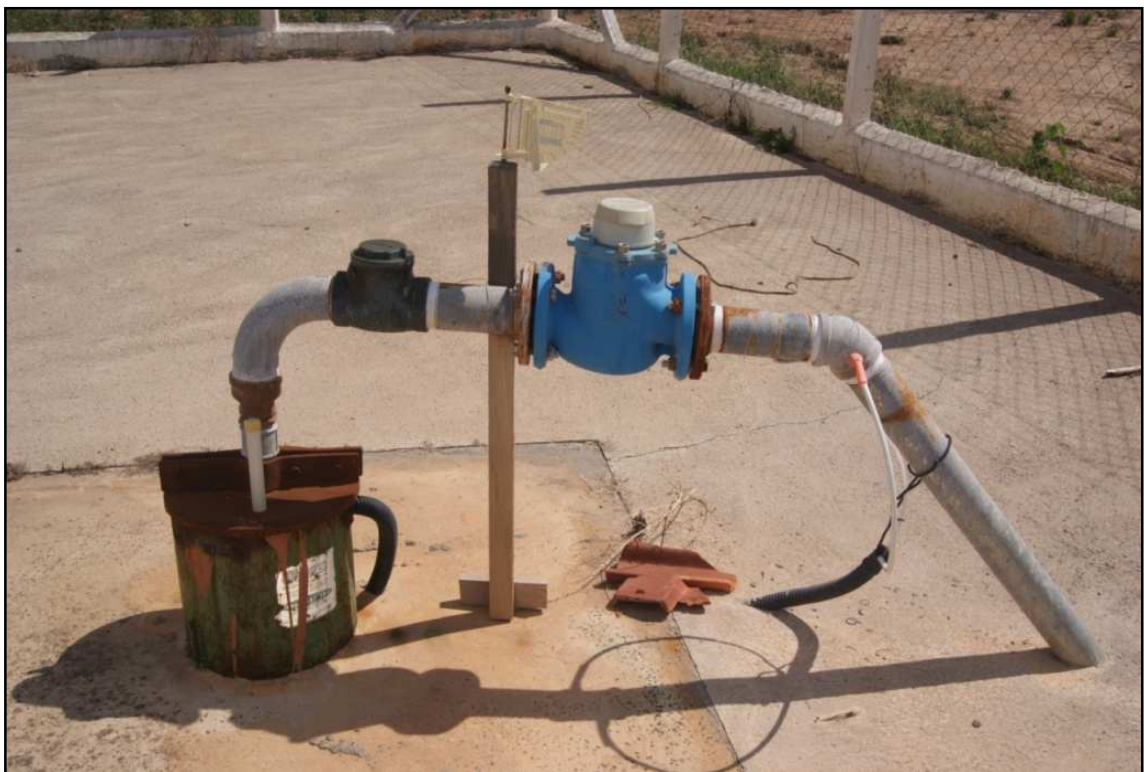
Foto 6: Poço Frigorífico. Fonte: Maximus Environmental.
